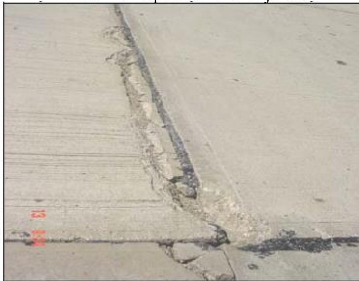
Foto 24. Desportillamiento de juntas.
