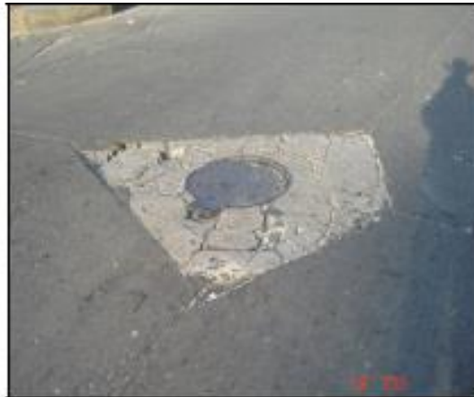
Foto 22. Grietas en pozo.
