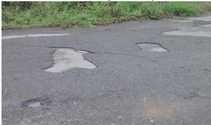
Foto 12. Descascaramiento. Localización. Vía antigua hacia san jerónimo
