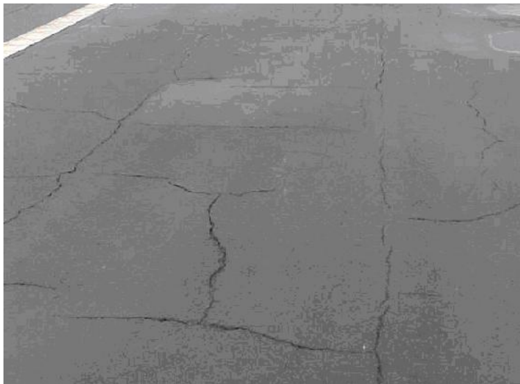
Foto 6. Fisura en bloque.
