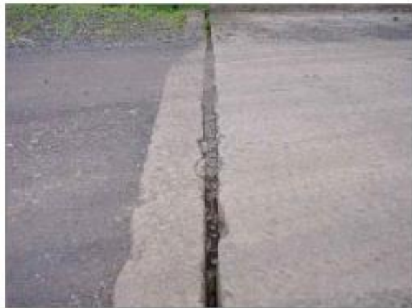
Foto 23. Deterioro de sellos.
