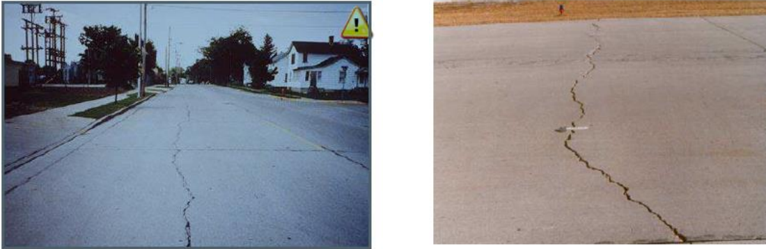
Foto 20. Fisuras longitudinales y transversales
