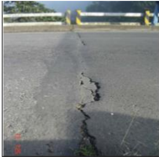
Foto 4. Fisuras en juntas en placas de concreto
