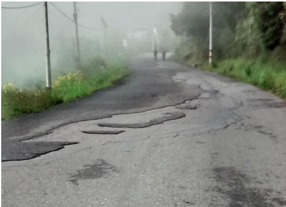
Foto 5. Fisura a media luna. Localización. Vía antigua hacia san jerónimo
