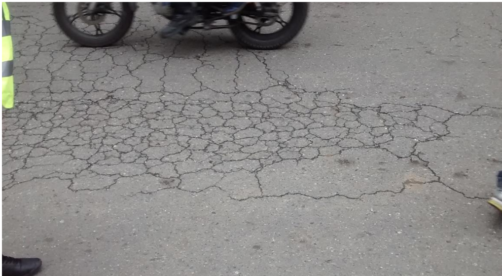
Foto 7. Fisuras piel de cocodrilo. Localización. Vía antigua hacia san jerónimo
