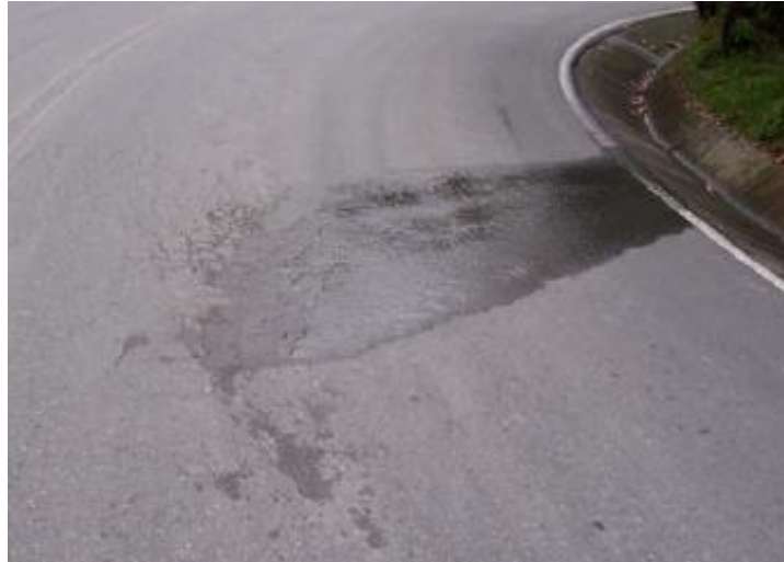
Foto 19. Corrimiento vertical de la berma.
