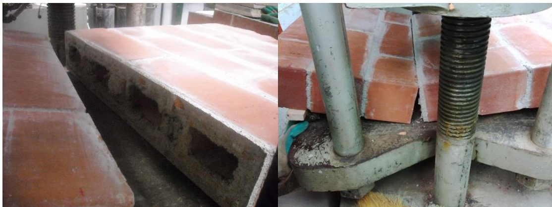
Foto 1. Falla por las juntas horizontales.
