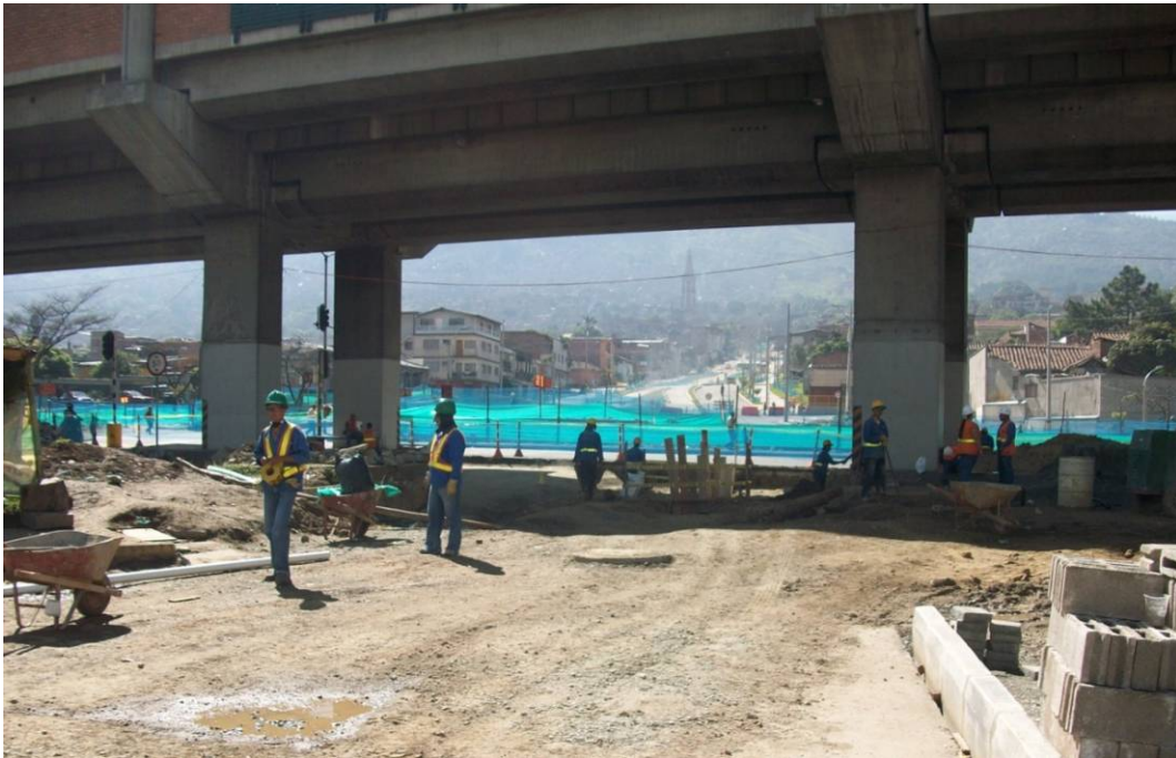
Anexo 2.8. Terreno sin adecuación para el riego de la mezcla en el tramo 2.
