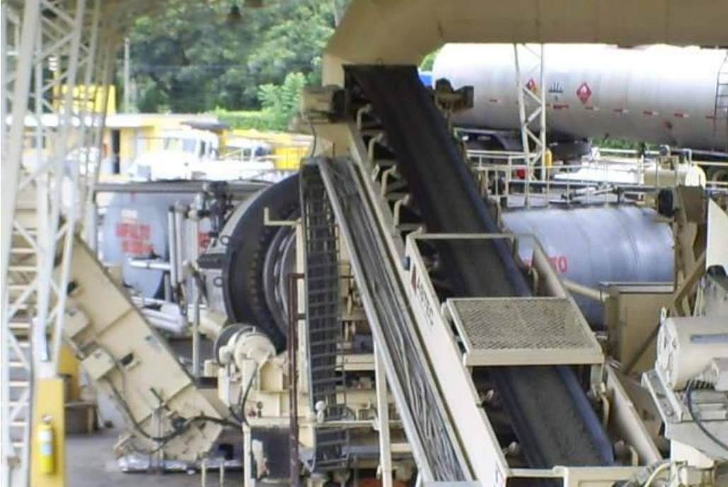
Anexo 1.8. Banda transportadora
