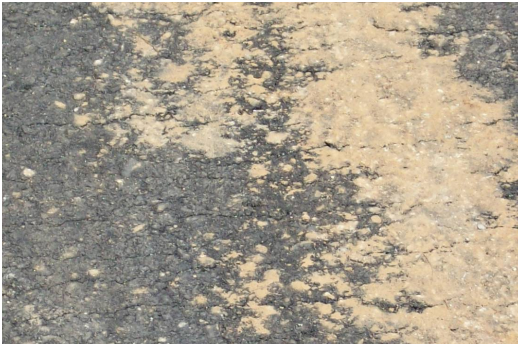
Anexo 2.18. Fisuras presentes en la carpeta asfáltica.
