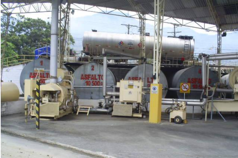
Anexo 1.16. Tanques de almacenamiento de asfalto.
