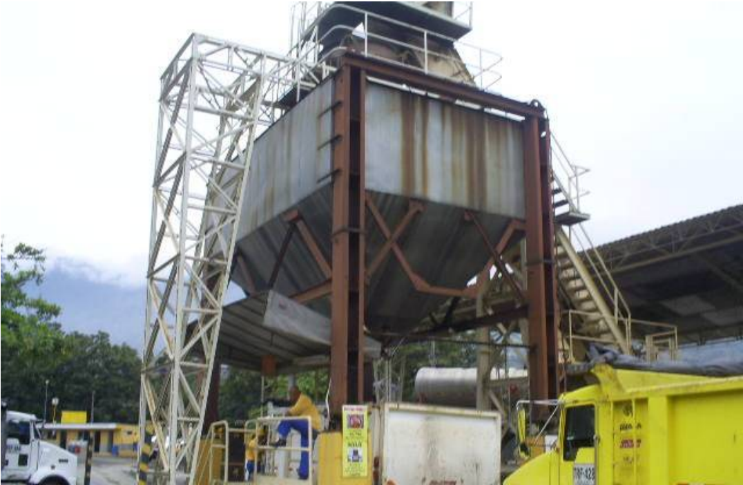
Anexo 1.9. Silo de almacenamiento del producto terminado
