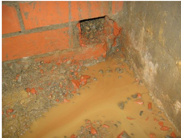
Figura 8 Afloramiento de agua en muro de contención.
