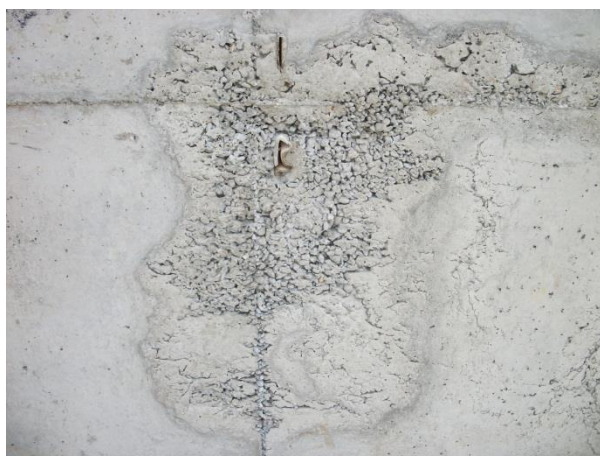
Figura1 Hormigueo en muro estructural
