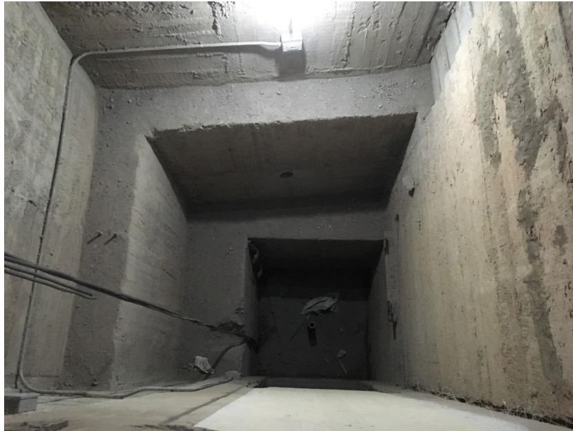
Figura 1. Muro de contención del foso del ascensor, colegio benedictinos Fuente: Foto tomada por Alejandro Ossa Durango
